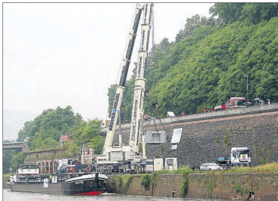
Am Haken: Zwei Kräne heben das 166 Tonnen schwere Gussteil - das ist das Gewicht von vier Leopard-Panzern - nach oben. Dort wird es auf den Lkw an der B 80 verladen. Fotos: Krischmann
