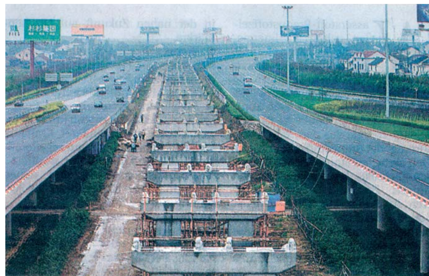
Fahrweg im rasanten Baufortschritt: Auf der 30 km langen Transrapid-Strecke vom Flughafen Pudong zur City soll Anfang 2003 die Erprobung beginnen. Foto: M. Darchinger
